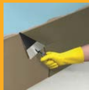
Aplikujte sanačnú omietku SikaMur® Dry
