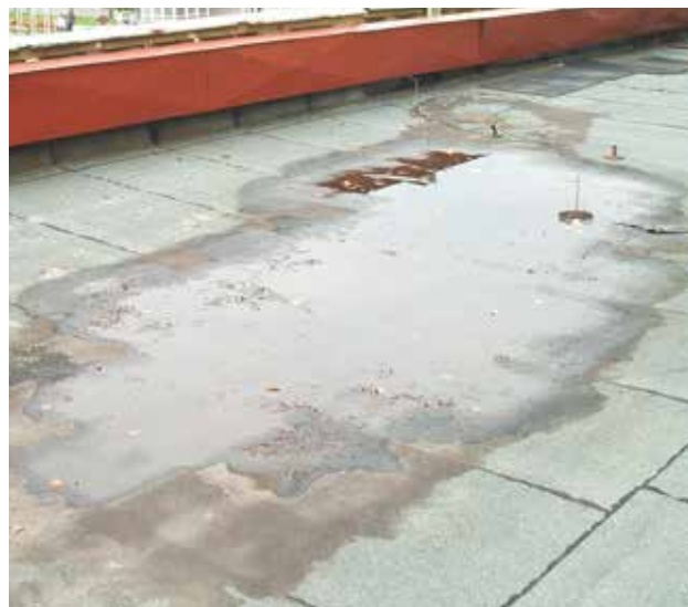
Nežiaduca kaluž vody na plochej streche.
