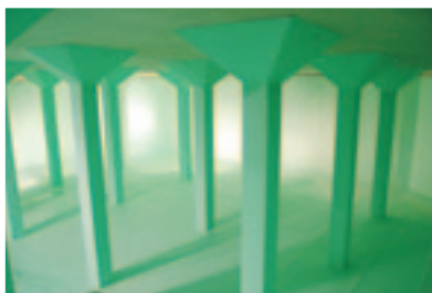
Izolácia zariadení na pitnú vodu
