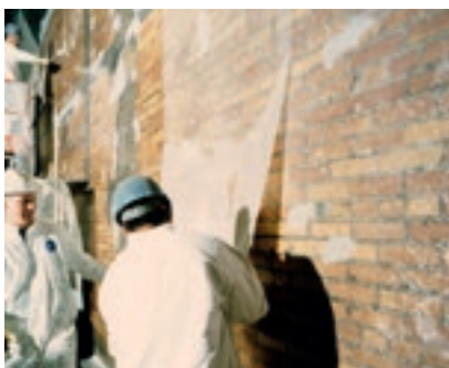
VYLEPŠENIE OHĽADNE SEIZMICKÝCH VPLYVOV / OPRAVA POŠKODENÍ PO ZEMETRASENÍ
